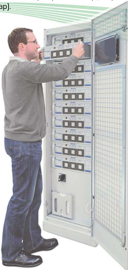
Configuração modular redundante HOT PLUG significa alta continuidade de operação e baixo MTTR (tempo médio de reparo)
