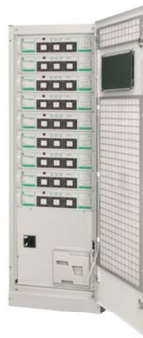
Sistema UPS com módulos de potência de 10kVA. Potência de saída 80 kVA (n +1)
